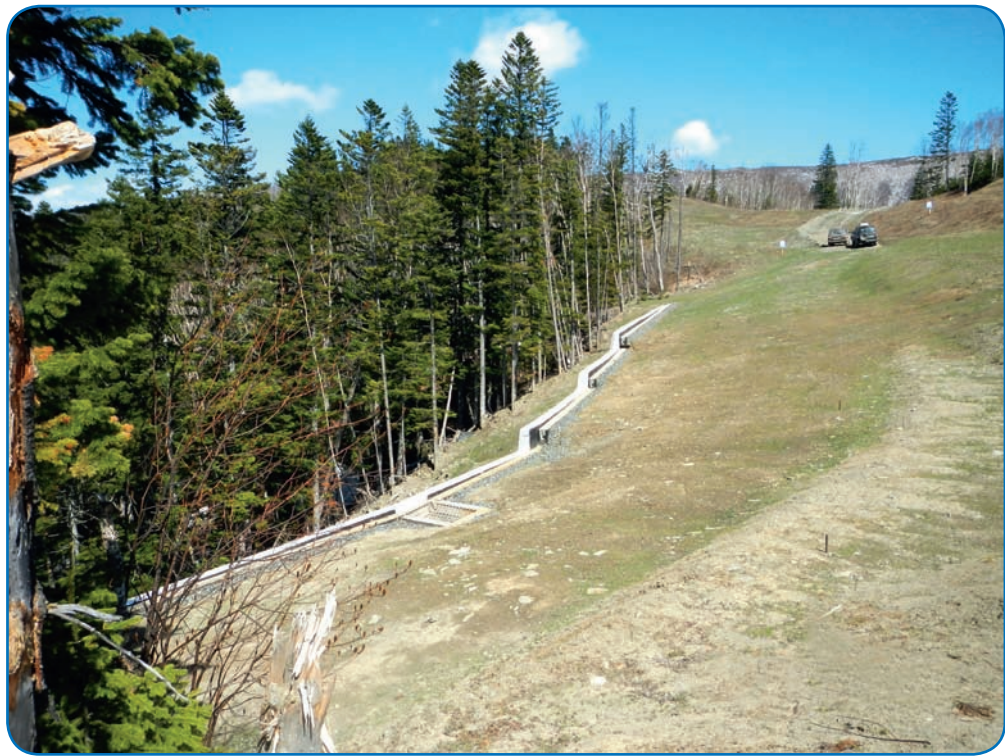
Полоса отвода нефтегазопровода, противооползневое сооружение, Макаровский район
